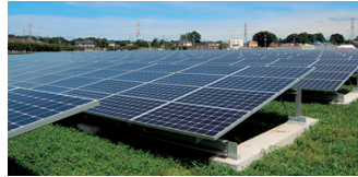
鹤岛太阳能发电厂 (埼玉县鹤岛市)
