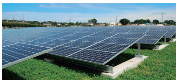
鶴島太陽能發電站
