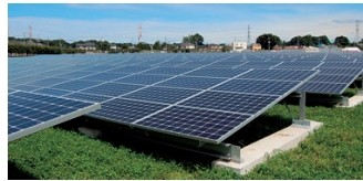
鶴島太陽能發電站 (埼玉縣鶴島市)
